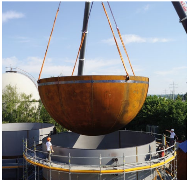
Einer der Böden der Ingolstädter Wärmespeicher
