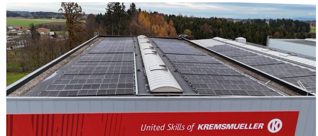
Neue Photovoltaikanlage am Standort Steinhaus
